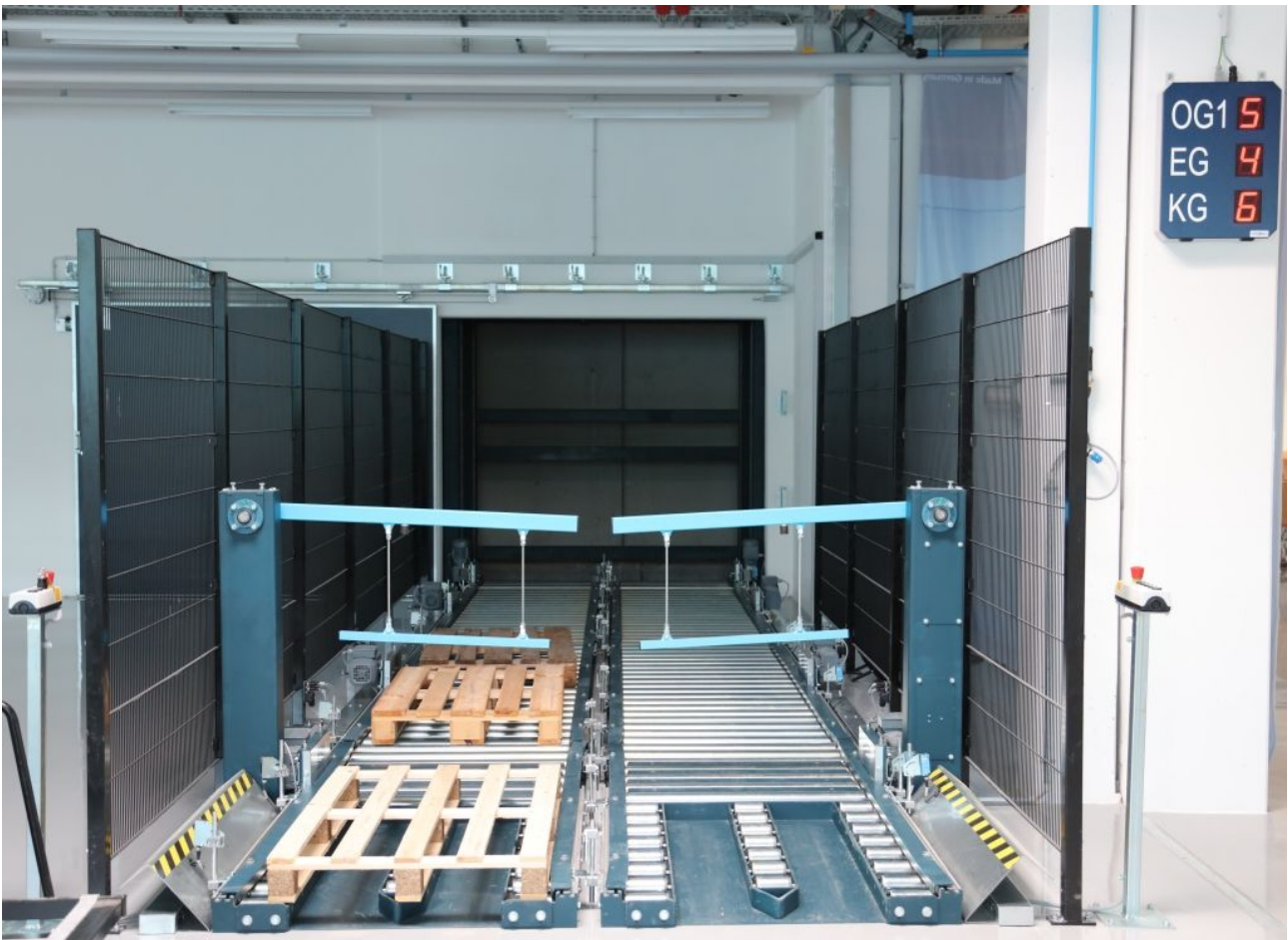
Pressebild: Vertikalförderer im blulog Lagergebäude.
